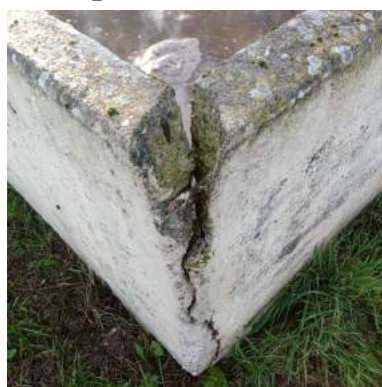
Angle du bassin d'aération
