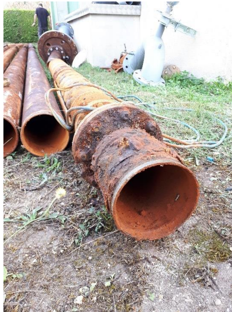
Forage de Monplaisir, à Savignac-sur Leyze Ancienne colonne
